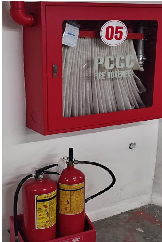
Hình 1-7: Bình chữa cháy và vòi phun nước công suất lớn.
